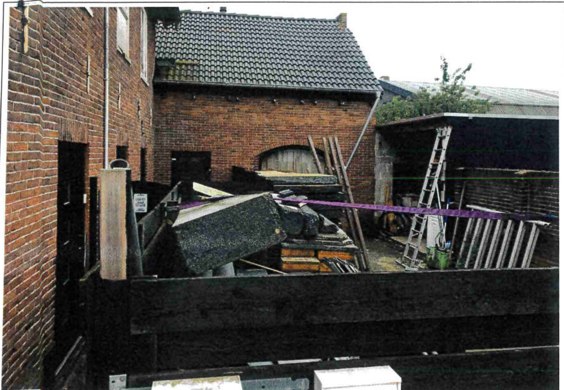
Het bijgebouw heeft een open zuidgevel. De erfafscheiding loopt vanaf de voorzijde tot tussen de voordeur en het raam van nr. 71A (met een knik). Tussen nr. 71a en nr. 73 is geen doorgang.
